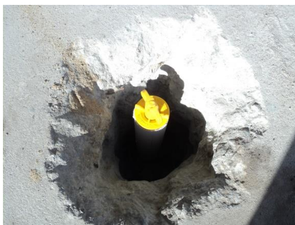
Figura 12 - Foto de poço de monitoramento (PM) instalado na área
